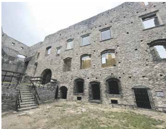
Dvoupatrové obytné křídlo renesančního Kühnova paláce hradu Hukvaldy prošlo rekonstrukcí za 4,2 milionu korun.
