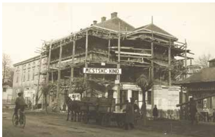
Stavba budovy kina a městského muzea v Místku (dnes kino Vlast), před rokem 1929.
